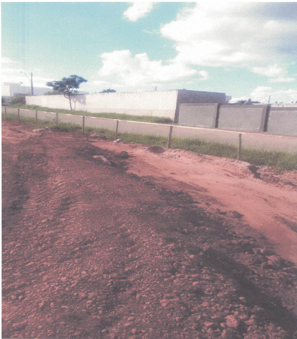
Foto 1 - Mostra a localização geográfica da disposição das aplicações das tubulações do sistema pluvial. A cerca exibida, é a divisa com o condomínio Etapa C.
