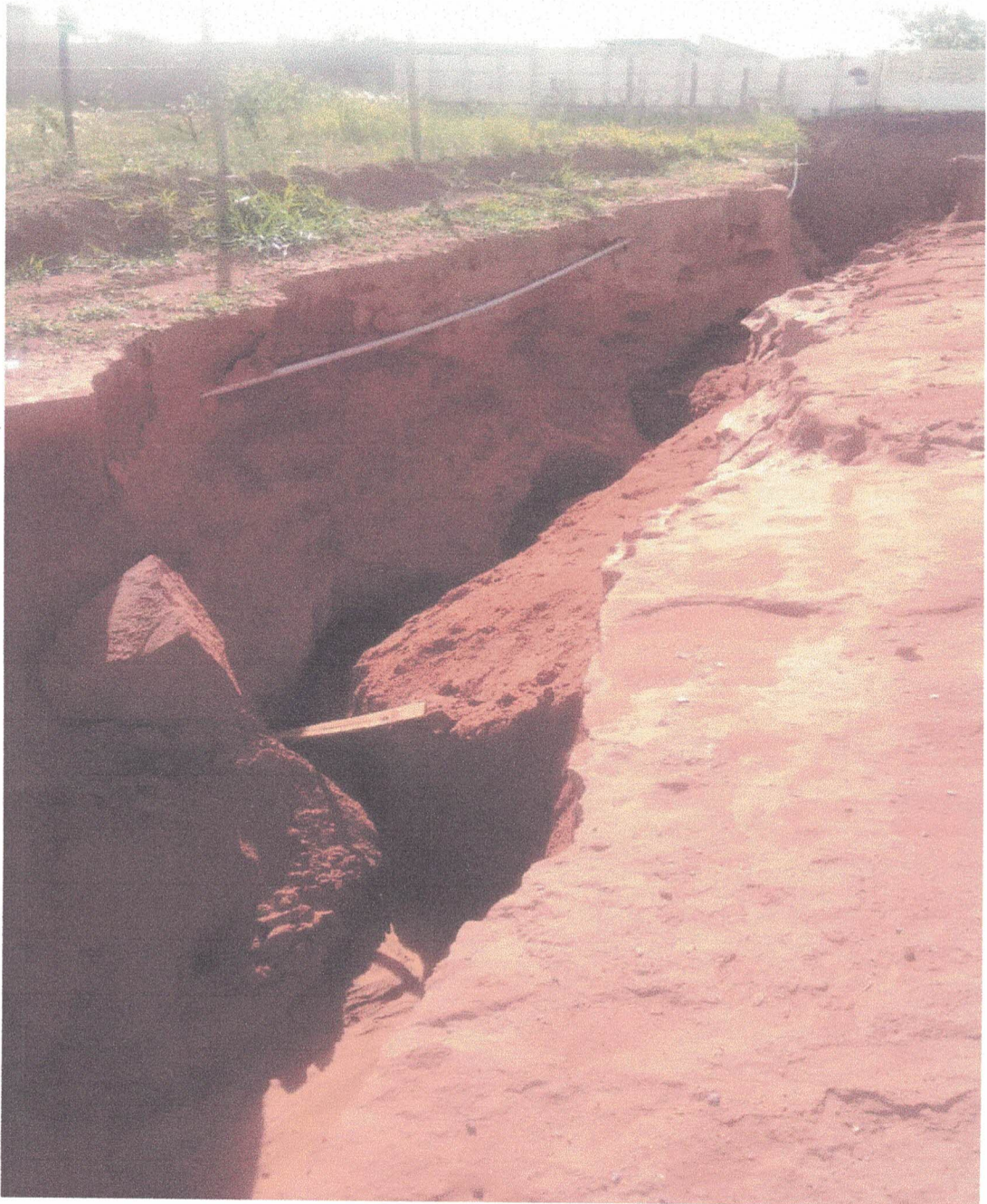
Foto 5 - Esta foto mostra o início de novo processo erosivo. Situado próximo a divisa com o Condomínio Etapa C. Notar instalação hidráulica danificada.
