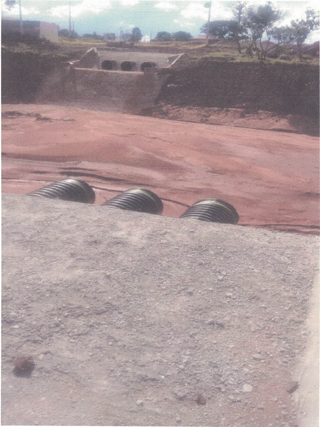
Foto 7 - Visão panorâmica do sistema de captação de águas pluviais, situado após o novo processo erosivo.
