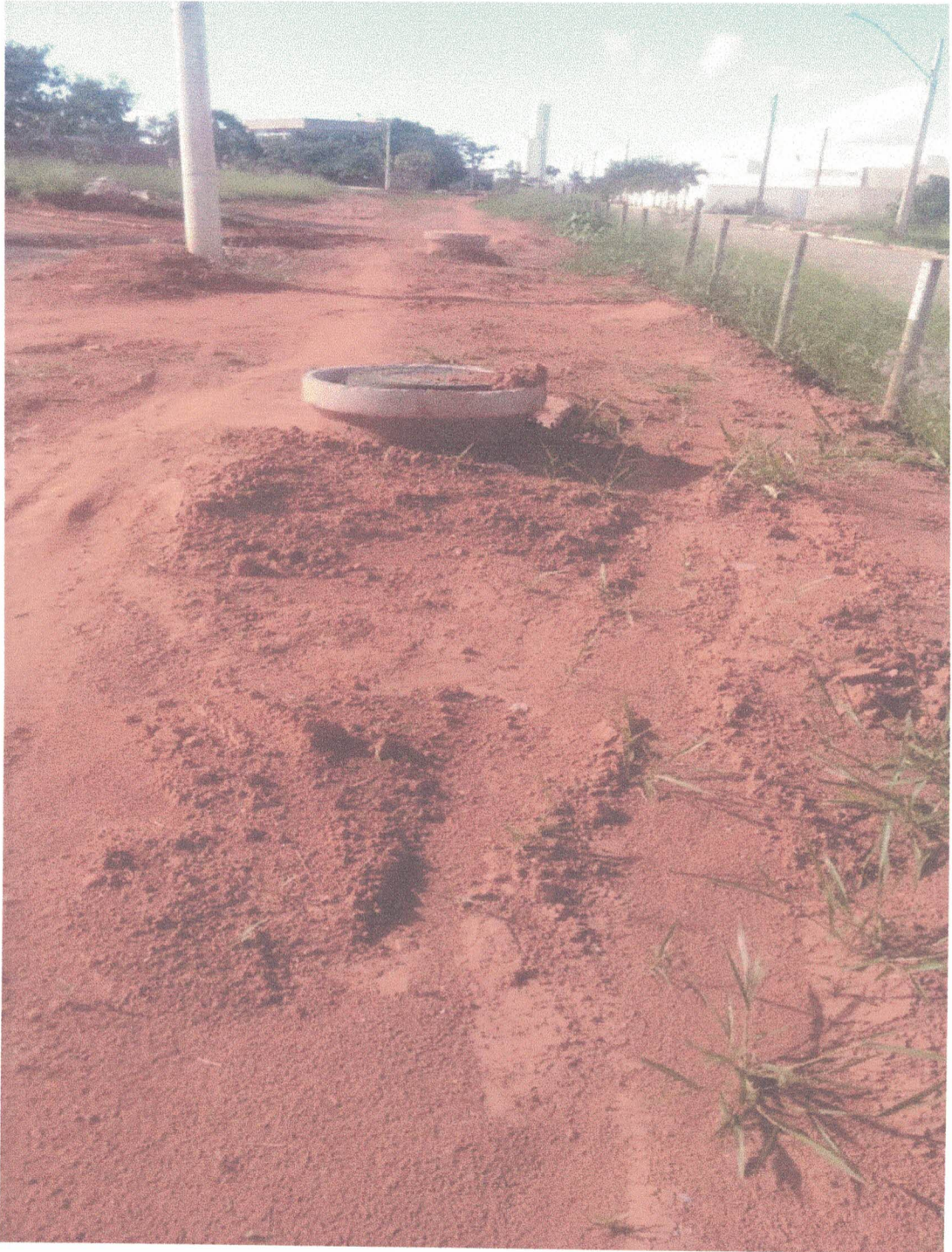
Foto 2 - Visão ampliada da disposição das tubulações do sistema pluvial.
