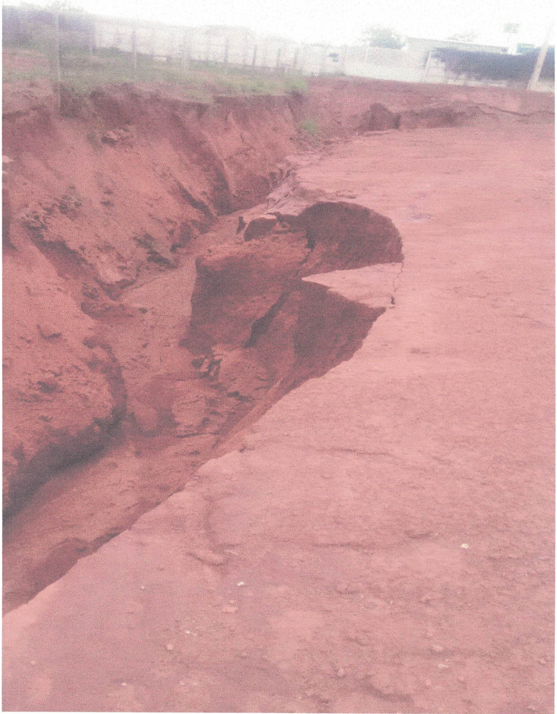
Foto 6 - Prolongamento do novo processo erosivo.
