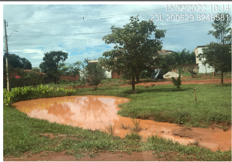
Foto 1. Retenção de escoamento pluvial de via interna não pavimentada.
