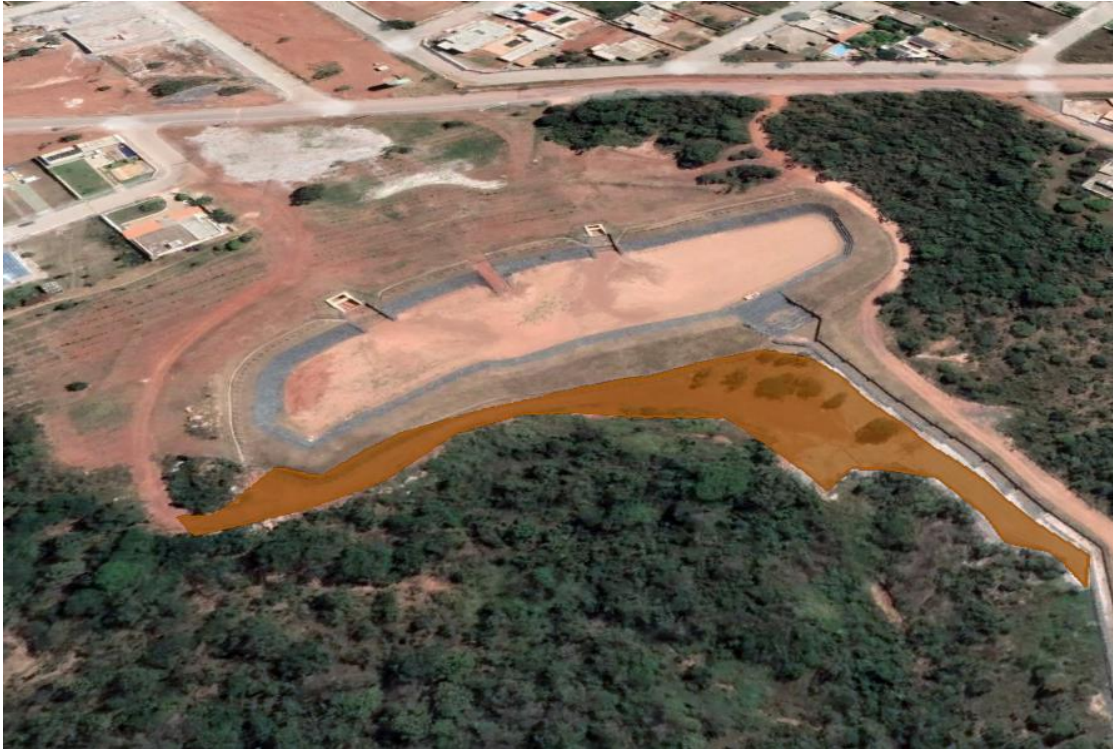
Figura 5 – Trechos que ainda não foram revegetados, considerando a movimentação de máquinas na faixa de serviço da obra – Imagem 01.
